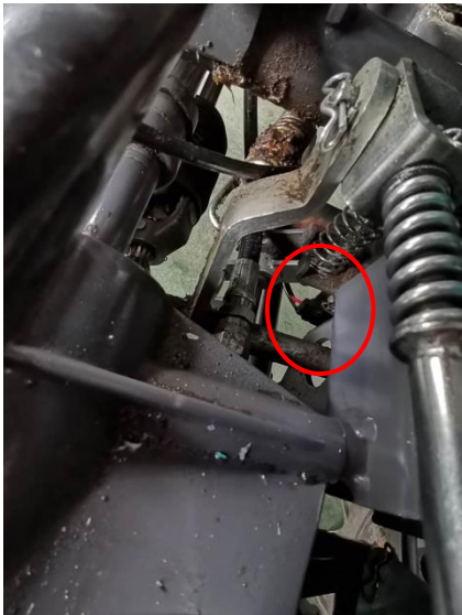
安全开关不良
